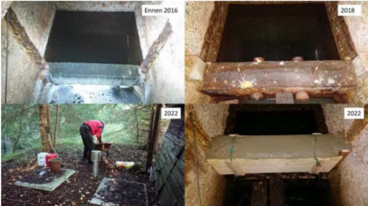
Kuva 41. Keuruun Ristakosken altaiden vedenpintaa korotettiin v. 2016 ja uudestaan v. 2022. valamalla kaivossa olevaan patoon lisää korkeutta. Vedenpintaa voidaan tarvittaessa laskea valun sisään laitettujen putkien kautta.
